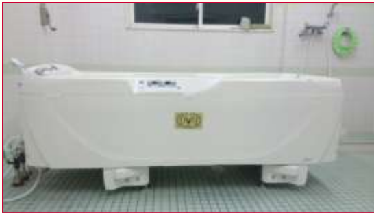
固定式介護浴槽
